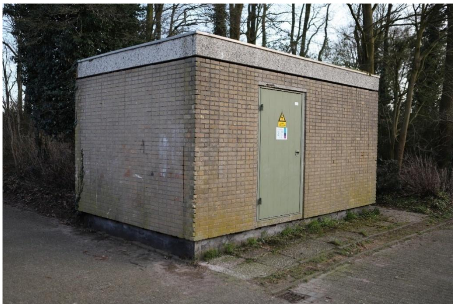
Figuur 64. Transformatorhuisje aan de 'Sandberg' (Monumenten Advies Bureau, 19 februari 2025).
